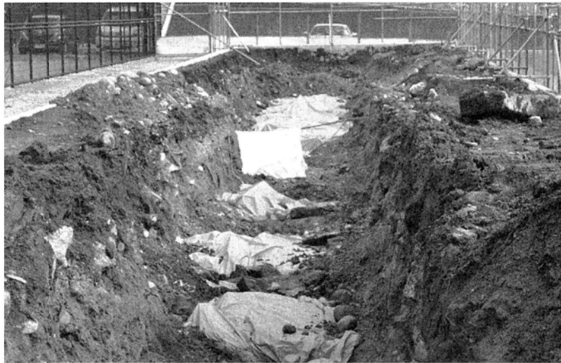
撤去されていないことが発覚し、現在ブルーシートで覆われている旧校舎の基礎コンクリート＝尾鷲市賀田町の市立輪内中学校で
