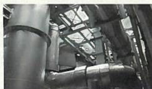
プラント配管
