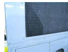
室外機の油にじみ
